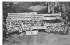
图4 混凝土离析缺陷照片
