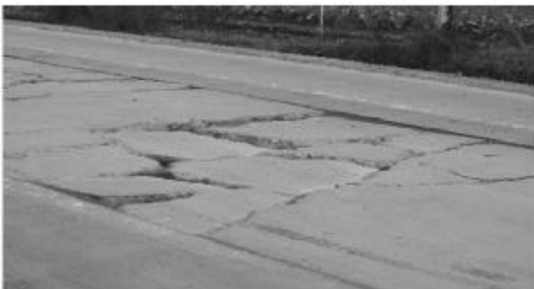
图 1-1 柳州市旧东环路开裂
