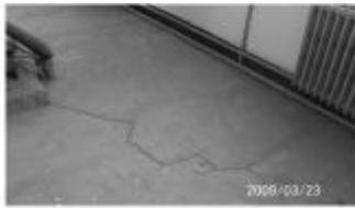
图8 坡顶房屋内地面出现裂缝
