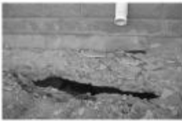
图7 边坡坡肩靠房屋处出现裂缝
