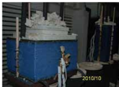
图2 运行结束的 1.5kW 电池堆
